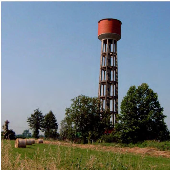
Torre piezometrica a Mediglia
